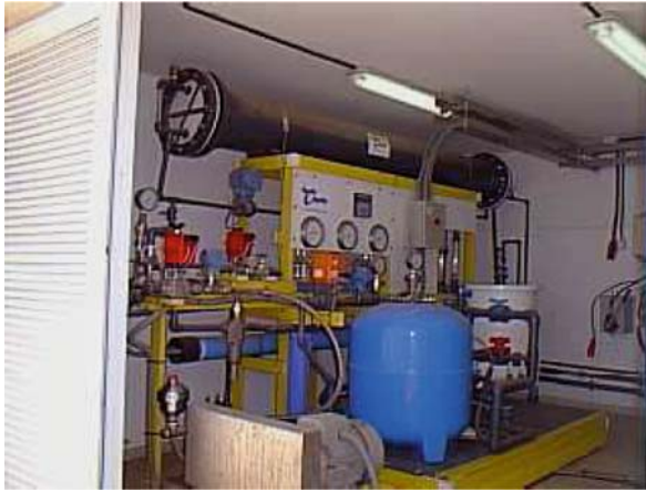
Fig. 9.21 The RO unit at Pozo Izquierdo Source: ITC
